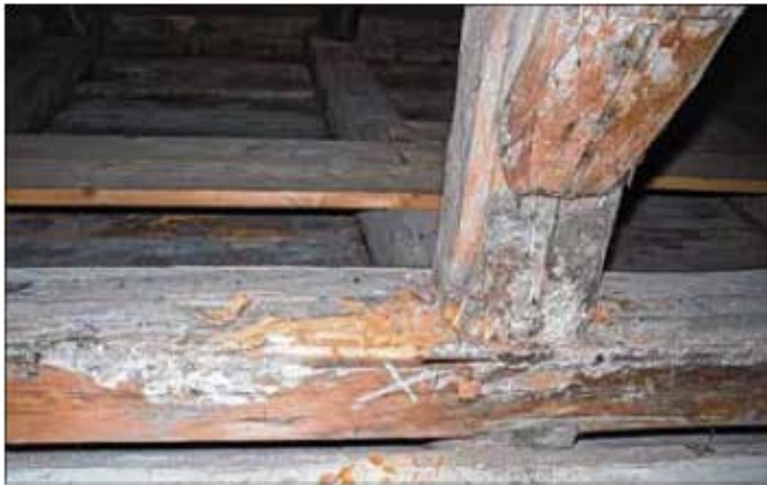
Einer der schadhafte Balken, die der Gutachter in der Wulferstedter Kirche entdeckt hat.
