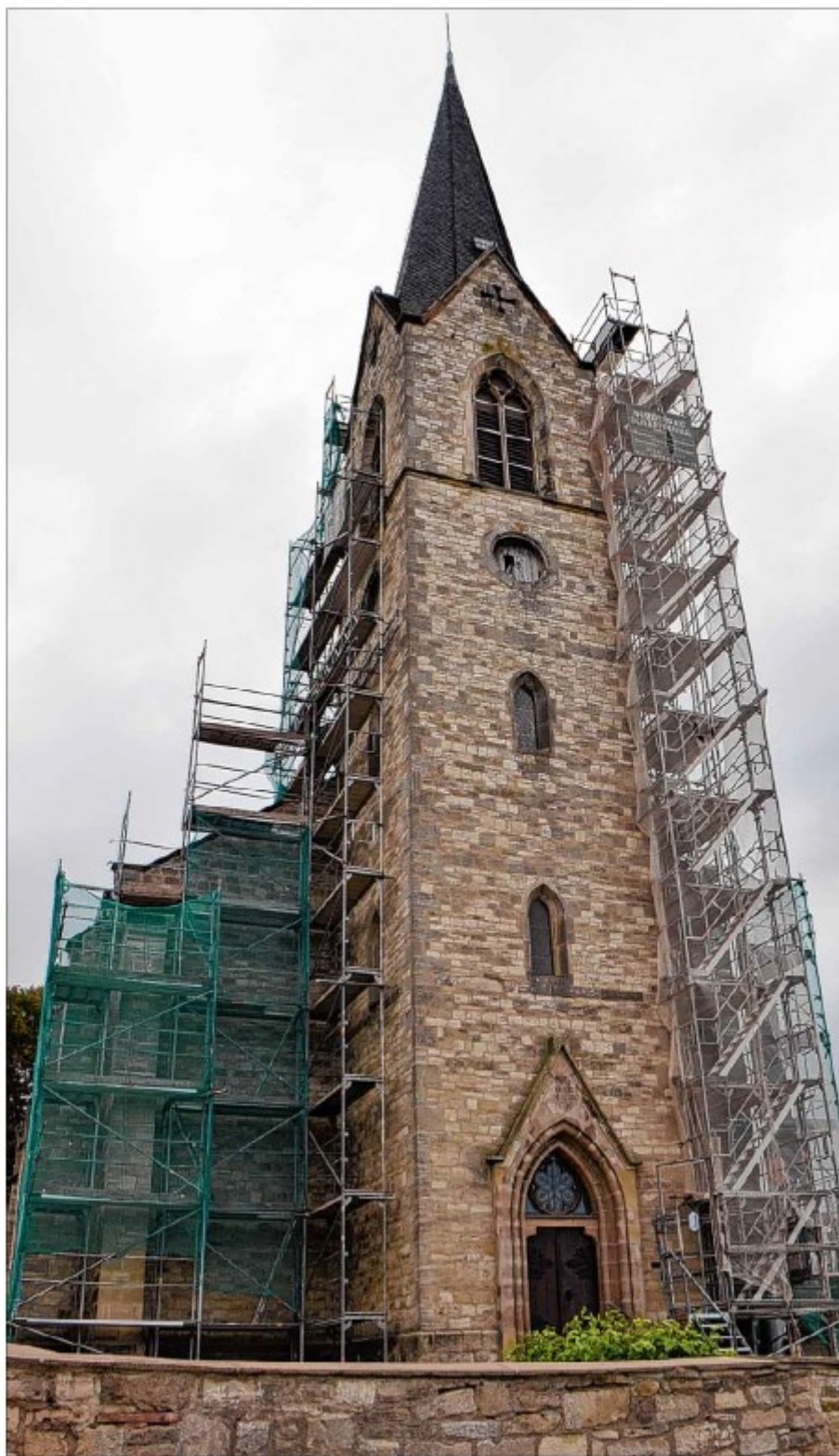
Am Turm der evangelischen Kirche in Klein Oschersleben kündigt ein riesiges Baugerüst von den Sanierungsarbeiten am Turm des Gotteshauses.
