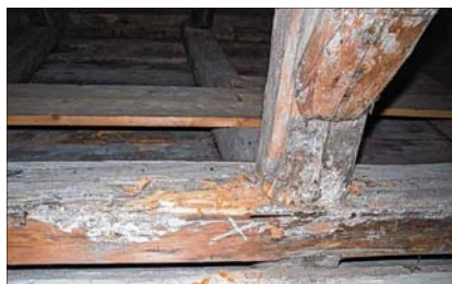
Einer der schadhafte Balken, die der Gutachter in der Wulferstedter Kirche entdeckt hat.
